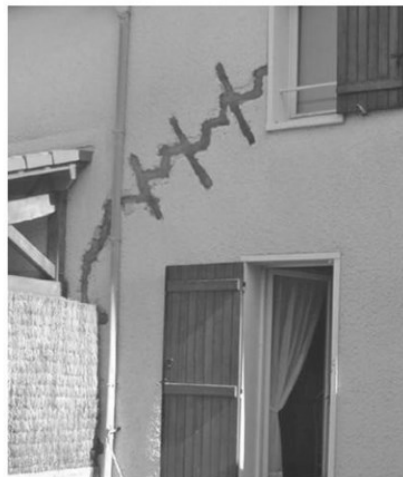
Réparation des dégâts produits par le phénomène de retrait-gonflement des argiles sur la façade d'une maison. Sources : BRGM ►
